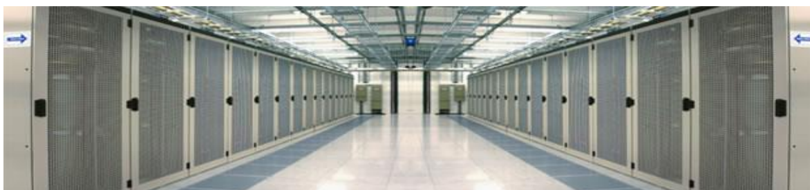
Figura 3. Exemplo de Data Center (Pescador, s.d.).
